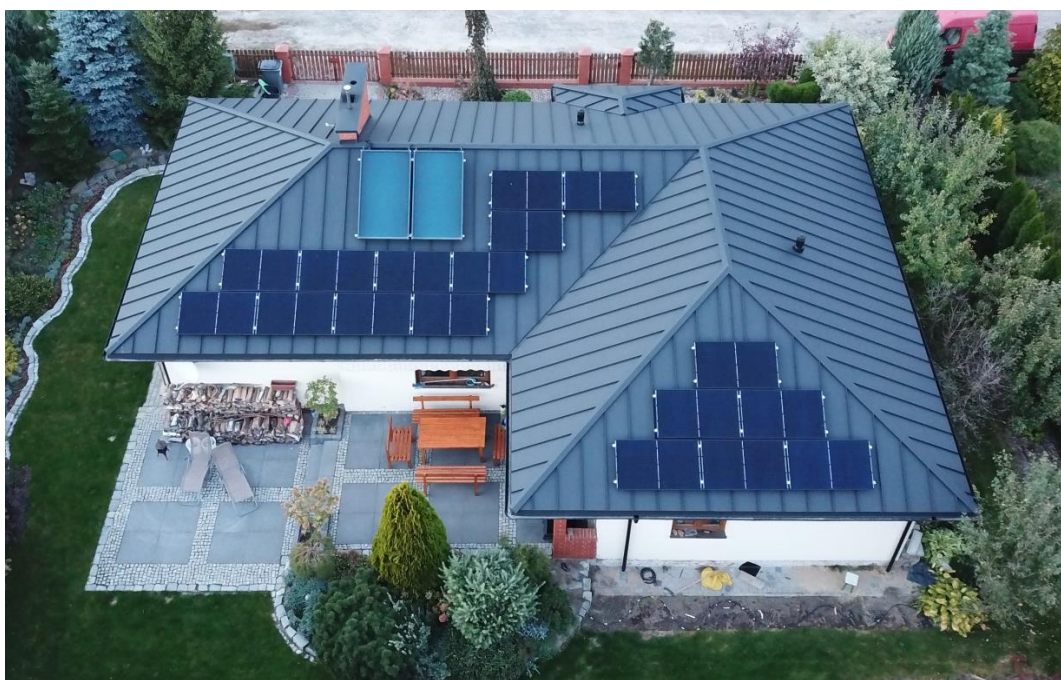
Zdjęcie nr 7 Instalacja fotowoltaiczna o mocy 5,18 kW zamontowana na jednym z budynków na terenie Lubartowa
